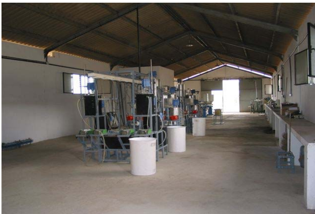
Vista general de la etapa de lixiviación
